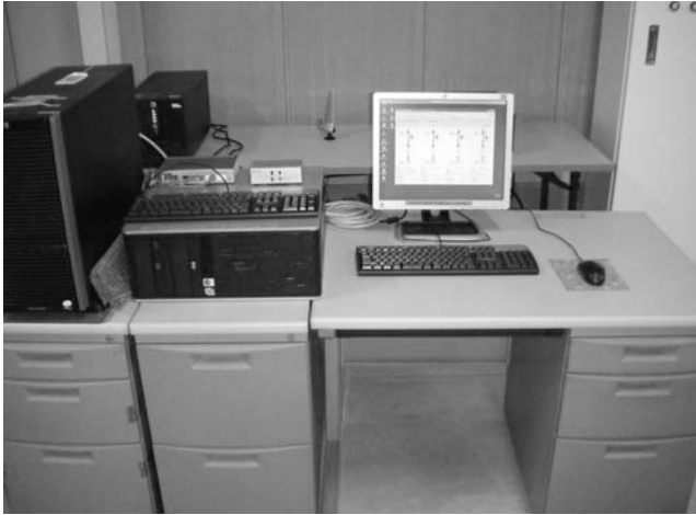
第3図 遠隔監視制御装置外観
