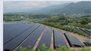
▲米倉山太陽光発電所
