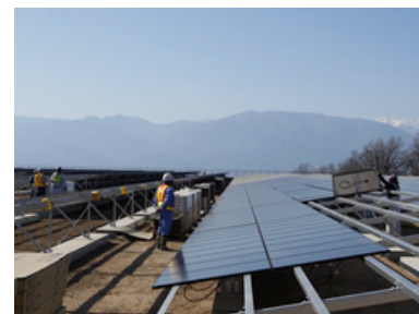
▲米倉山のメガソーラーのPCSも明電舎のもの。
