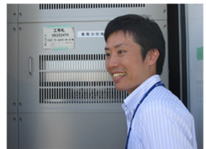
▲屋上に設置されたリチウムイオン蓄電システムの前で語る宇山
