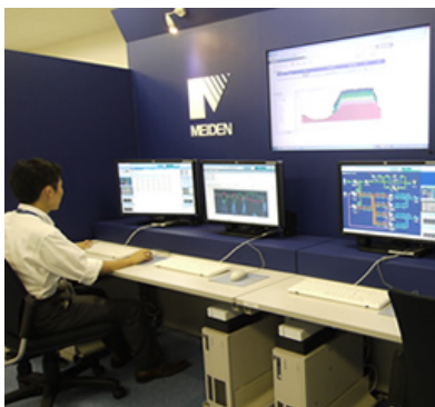
▲スマートBEMSが稼働する監視操作卓
