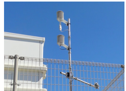
▲横浜ワールドポーターズの屋上にある気象センサ
