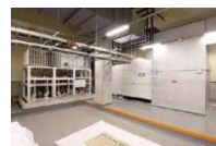
情報通信、ビル電源
