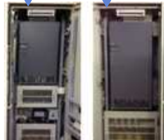
可変速コンバータ盤
