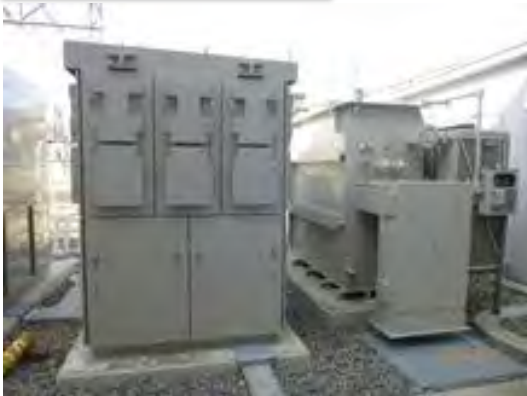
整流器用変圧器・整流器 (交流⇒直流に変換する)
