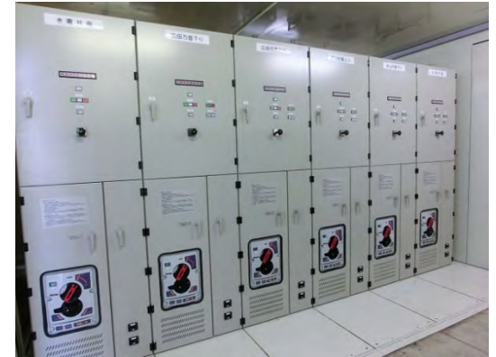
直流配電盤 (直流スイッチ)
