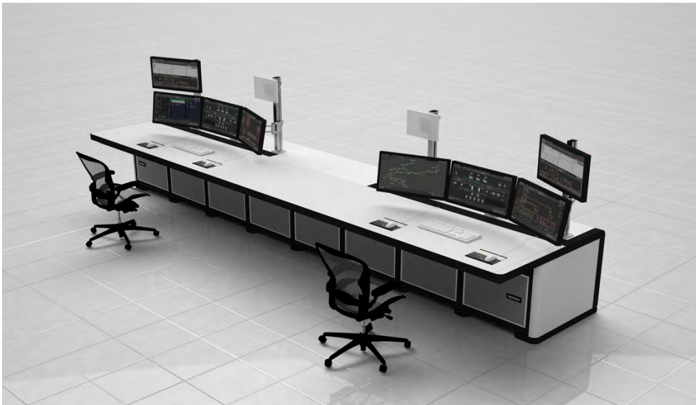
監視・制御卓
