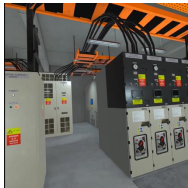
VR システムで再現した変電設備
