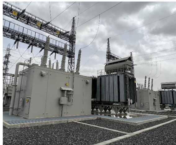
新坂井変電所
