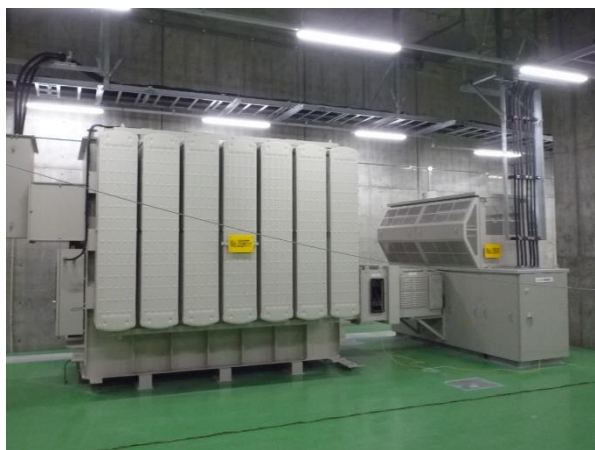
整流器用変圧器（左） シリコン整流器（右）
