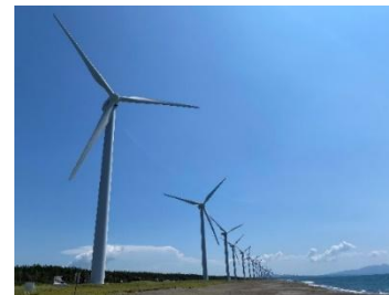
秋田県三種町 八竜風力発電所
