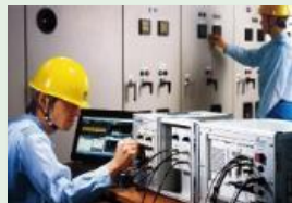
電気設備のメンテナンス
