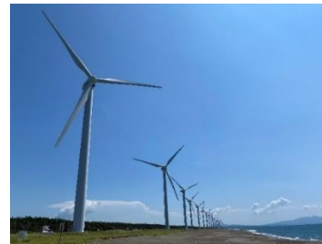
秋田県三種町 八竜風力発電所
