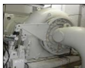
水力用発電機
