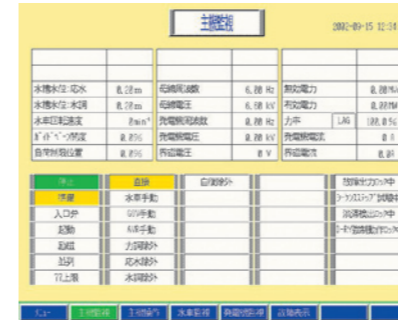
主機監視画面
