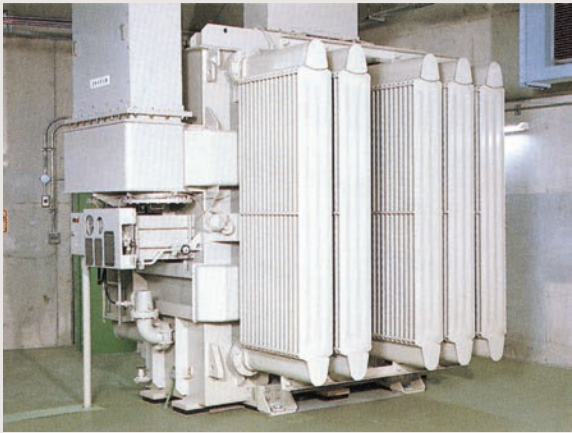
ガス絶縁変圧器
