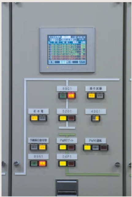
監視・制御盤面例
