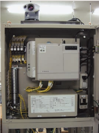
変電所内装置
