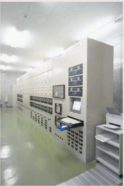
監視・制御設備例(2)
