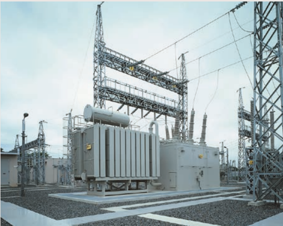
154kV スコット変圧器
