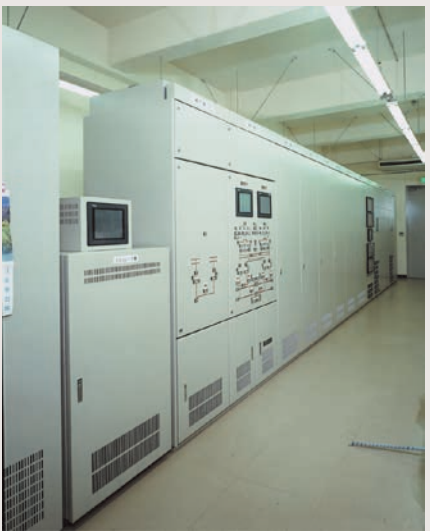
監視・制御設備例(1)
