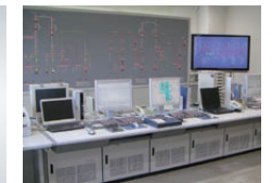
電力用監視制御システム
