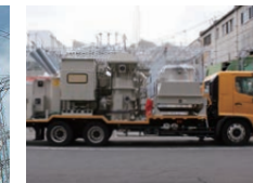
移動用変電設備
