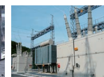
ルーフ・デルタ結線変圧器
