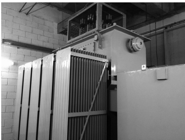
Fig. 2 3300kVA Rectifier Transformer
