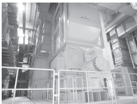
23MVA 非常用自家発電設備
