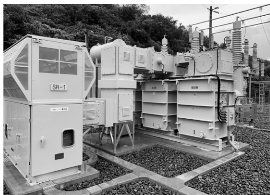
第3図 更新後の整流器用変圧器
