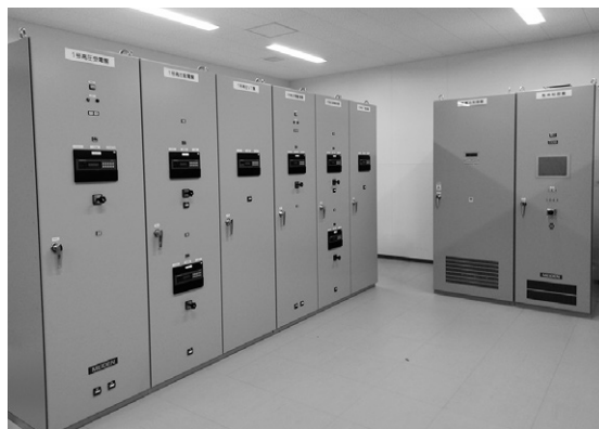
第2図 高圧配電設備
