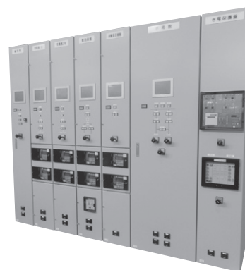
第5図 温田変電所 主配電盤
