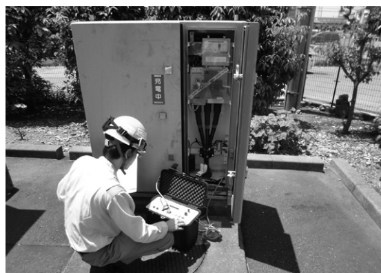
第7図 活線高圧ケーブル診断
