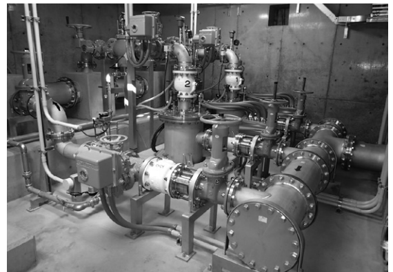
第11図 館林第二浄水場送水ポンプ設備（55kW×2台）
