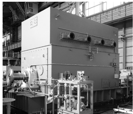
第6図 蒸気タービン発電機
