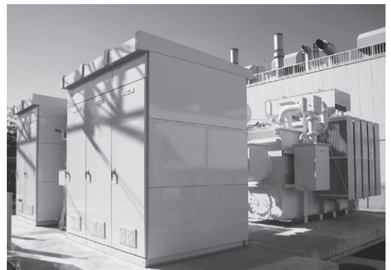
第3図 77kV特高受変電設備
