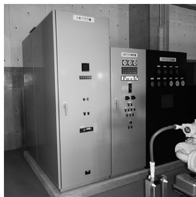
第3図 多機能デジタル保護制御装置
