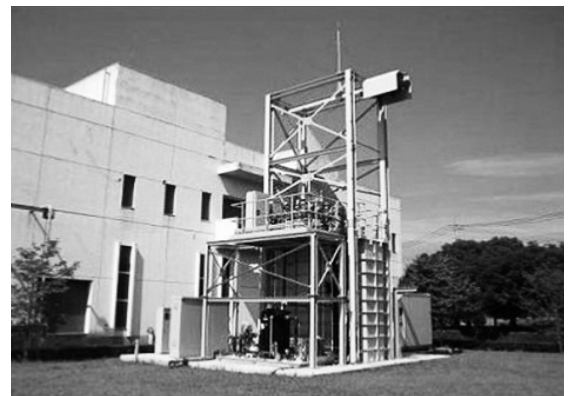
第5図 実証実験プラント
