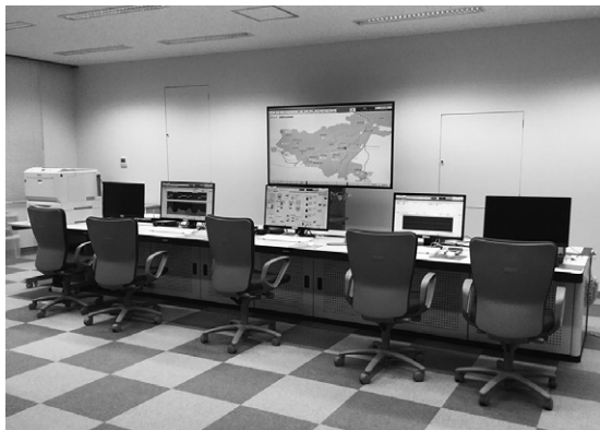
第1図 集中監視設備
