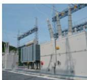
70MVAルーフ・デルタ結線変圧器
