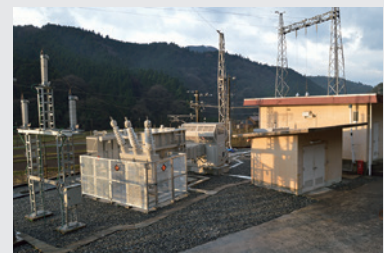
変電所全景（SRあり）
