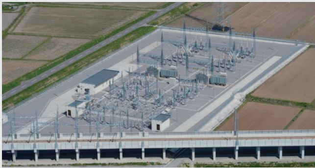
北海道新幹線新函館変電所
