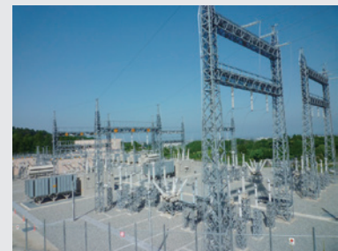
北陸新幹線新黒部変電所
