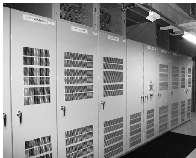
第4図 電力回生機器
