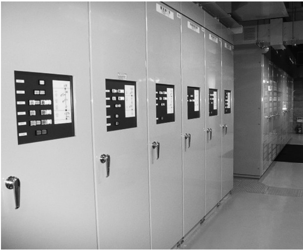
第1図 24kV特高機器
