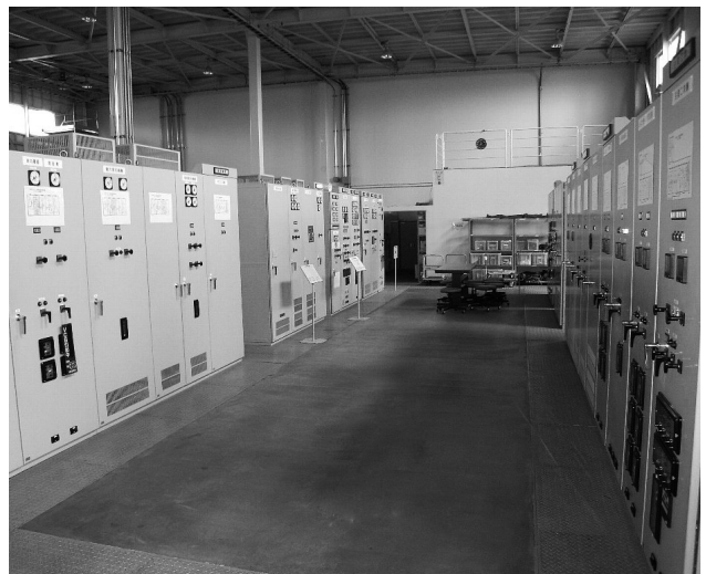
第3図 高圧受変電設備
