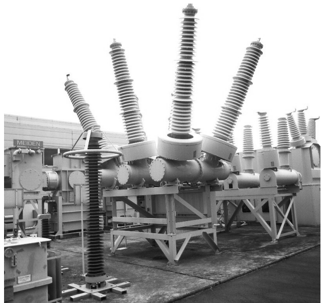
第2図 特高受変電設備
