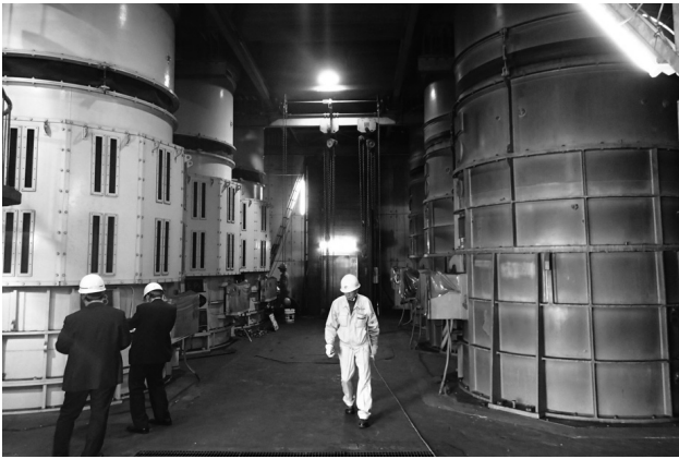
第1図 古城立坑更新前の換気設備
