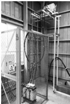
(b) 6kV昇圧用設備
