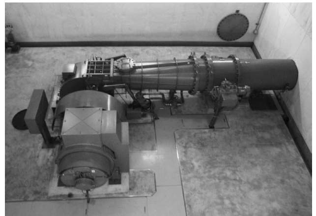
第3図 クロスフロー水車発電装置
