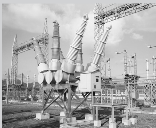
204kV 2点切りタンク形VCB
