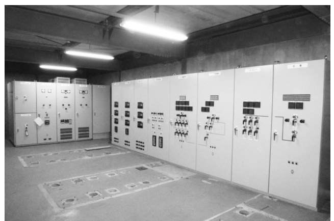
第24図 監視操作盤
