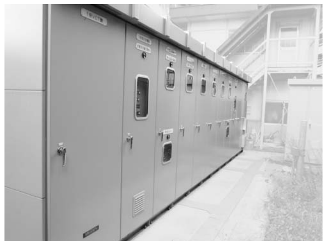
第26図 高圧配電設備
