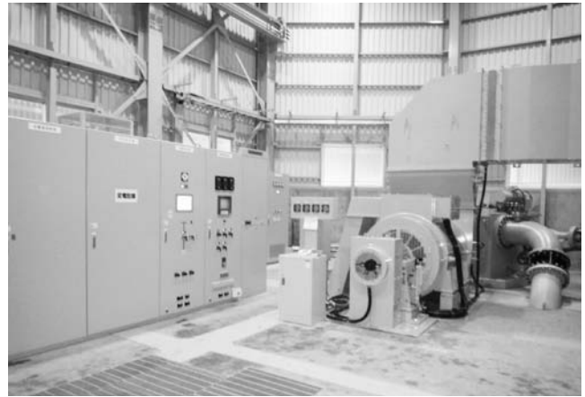
第1図 水力発電設備
