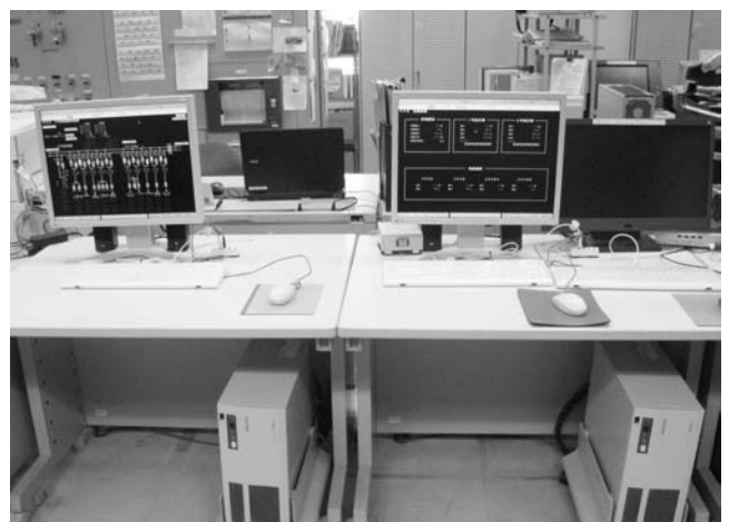
第21図 監視装置
