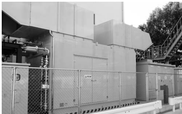
第8図 常用発電設備
