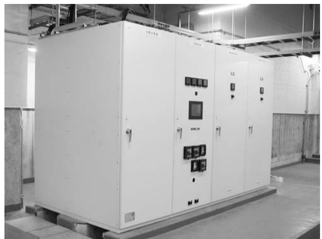
第17図 新形標準非常用発電機盤
