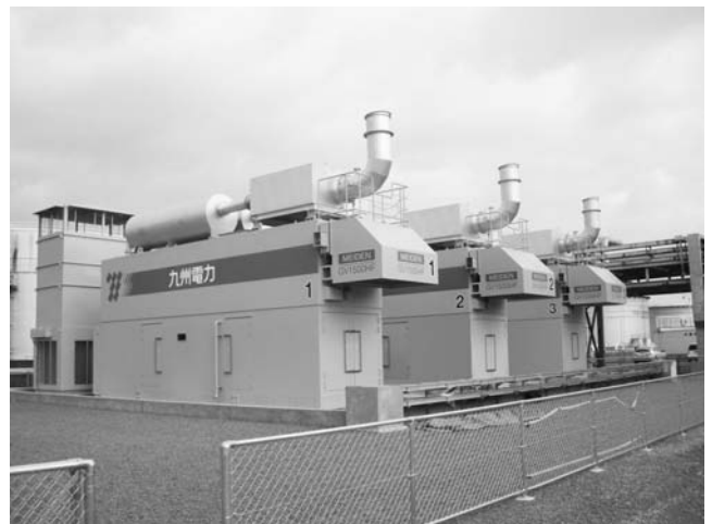
第12図 1500kVAディーゼル発電装置
