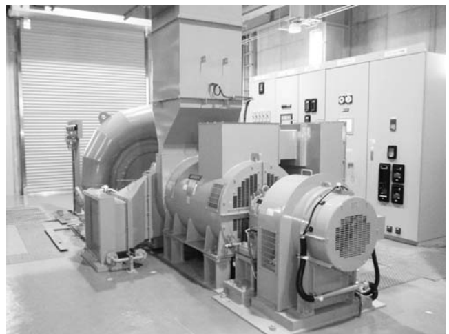
第2図 水車発電設備
