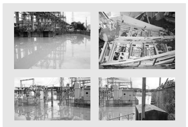
第27図 変電所被害状況
