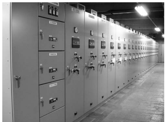
第23図 高圧配電設備
