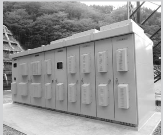
1MVA SVC装置
