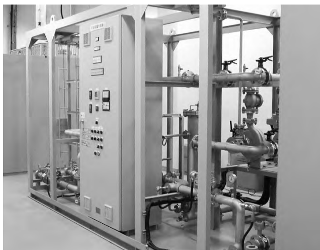
第4図 インバータ盤・冷却ポンプ
