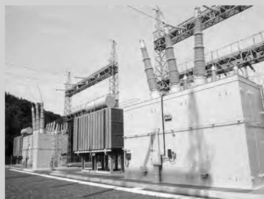
九州新幹線新玉東変電所納入70MVAルーフ・デルタ結線変圧器
