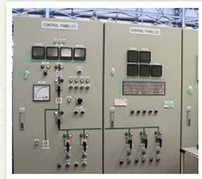
▲フィーダーを制御するコントロールパネル
