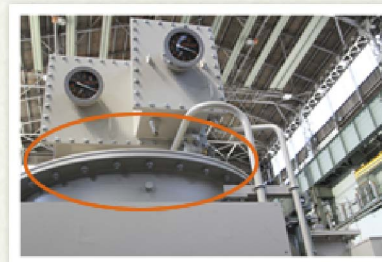
▲しっかりとシーリングされた絶縁油充填部
