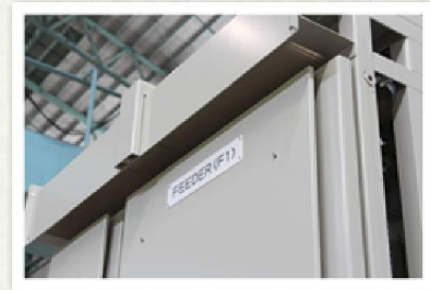
▲キュービクルは、断熱のため外壁が2重構造になっている。
