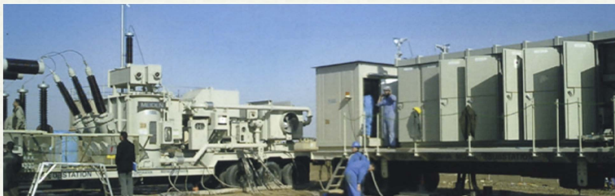
▲移動変電所は、トレーラーA(左)に断路器、真空遮断器、変圧器を搭載。トレーラーB(右)に、制御盤・フィーダー盤を納めたキュービクルを搭載。
