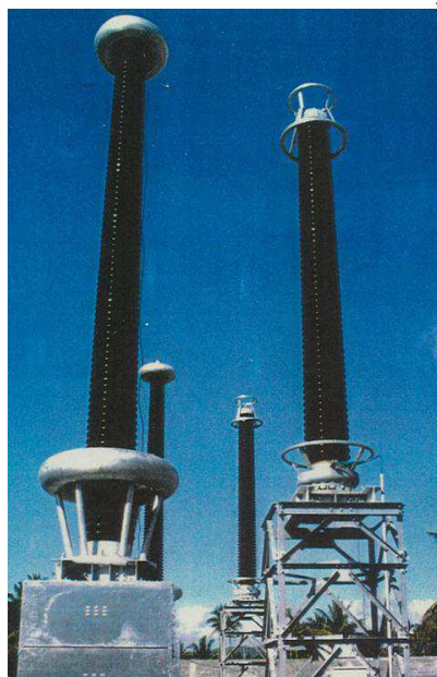
350kV用直流避雷器
