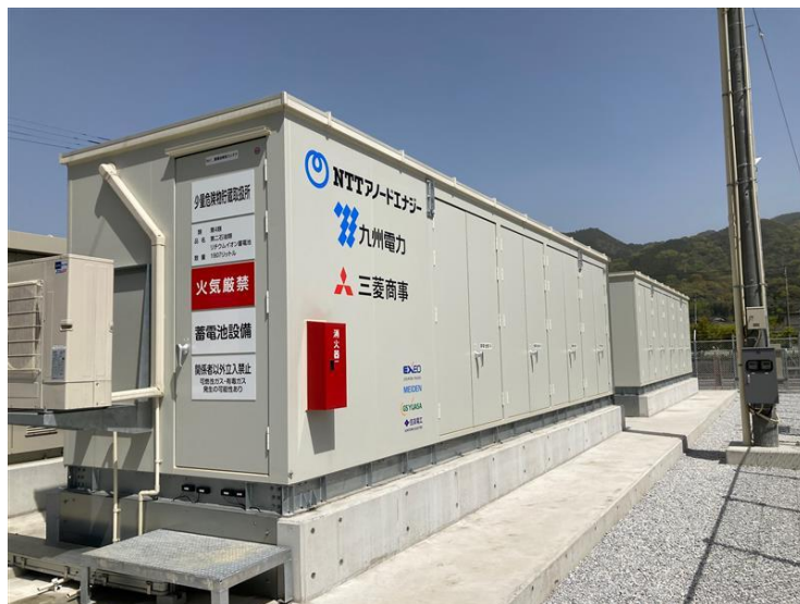
福岡県田川郡香春町 に設置されたリチウムイオン電池システム
