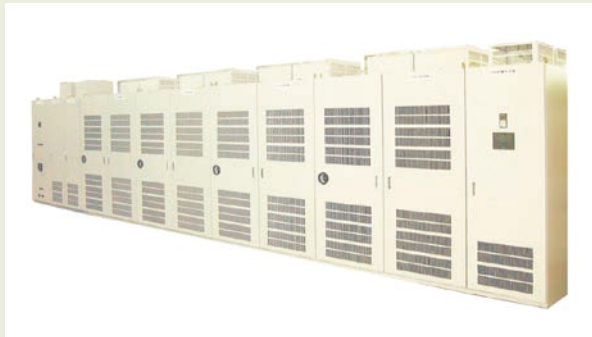
4000kVA周波数変換装置(2010年納入)▶
