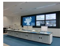
総合監視システム
